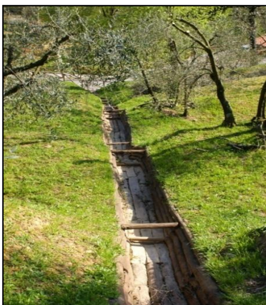
Canali di scolo per il drenaggio dei versanti
